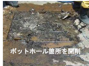
写真1 RC床版上面の劣化状況（舗装上から撮影）
