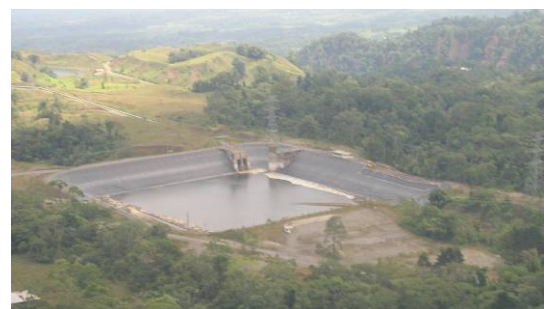
写真 5 ロックフィルダム被害状況
