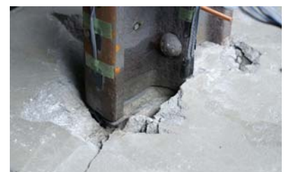
写真-2 2本組レールの破断状況 (試験体 No. 3 (強軸方向載荷))
