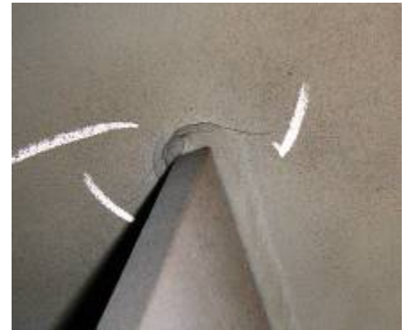
図-1 垂直補剛材の疲労き裂
