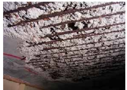
写真1. 床版下面の損傷状況.
