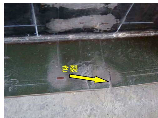
図-4 引張フランジに発生したき裂(No. 1)
