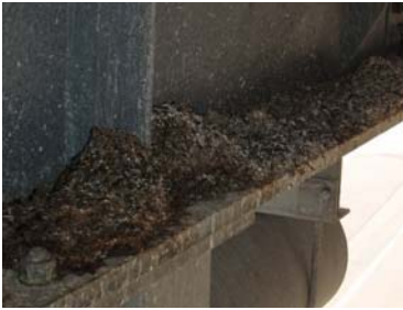
写真-3 鳩糞の堆積状況
