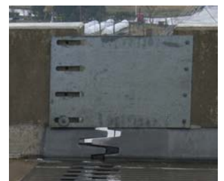
写真-6 止水板のボルト脱落
