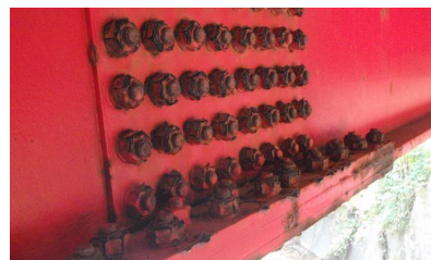
写真-1 ボルト部の発錆状況
