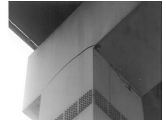
写真-1 鋼製橋脚に発生した脆性き裂
