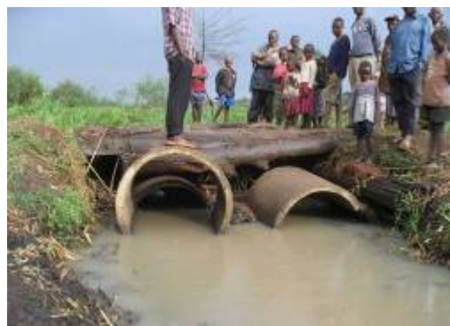
写真4 補修前の橋の様子(ケニア)
