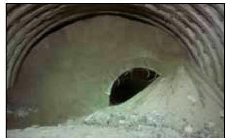
写真-5 崩壊状況
