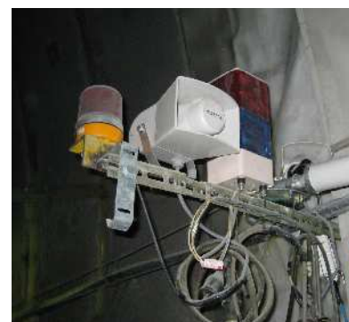
写真-1 坑内警報装置
