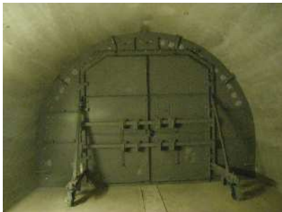
写真-2 避難坑防爆扉(鋼製)
