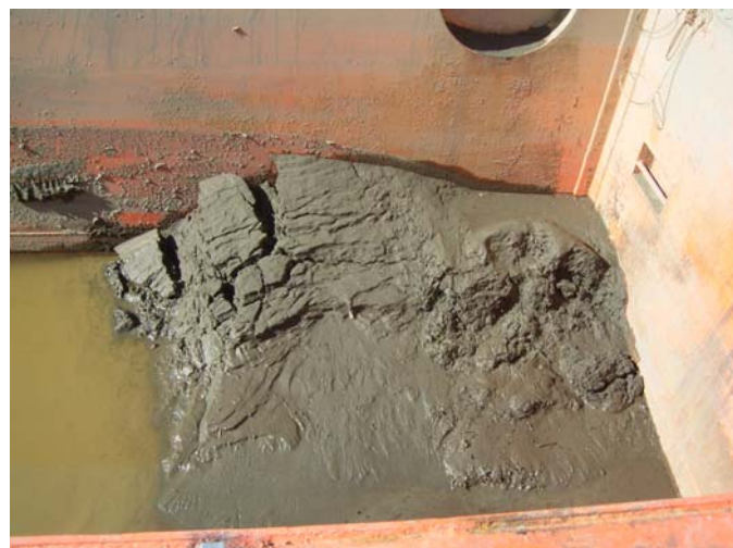
写真-3 タンク内に排出された土砂
