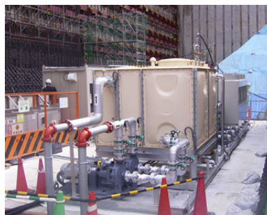
写真-1 チラーユニット
