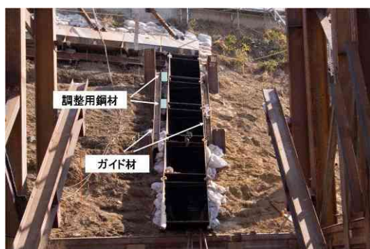
図-6 振れ止め設備
