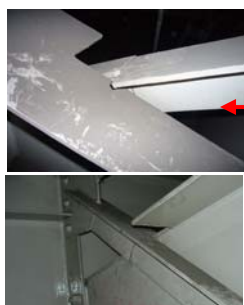
写真-1 斜材切り欠き部の破断状況
