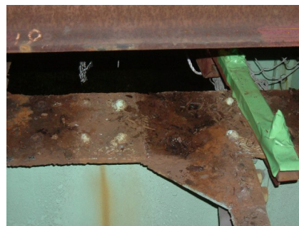
写真1 桁上フランジの腐食状況
