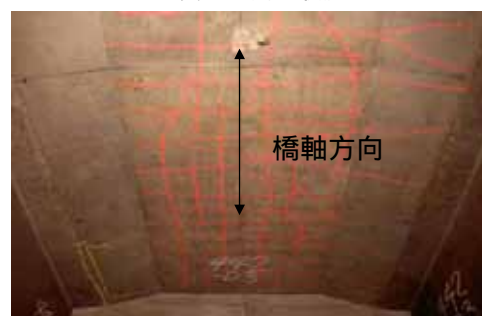
写真-2 補強前床版のひび割れ
