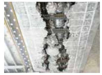
試験体下面の空洞
