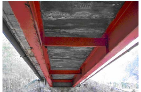
写真-2 施工前・床版損傷状況
