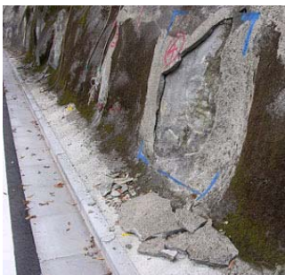
図 5 老朽化した法面
