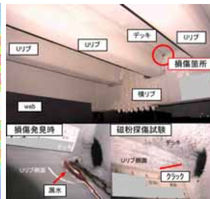
写真-1 滞水Ｕリブ箇所
