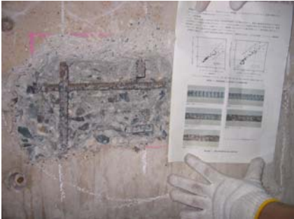
図-1 露出した鉄筋の例
