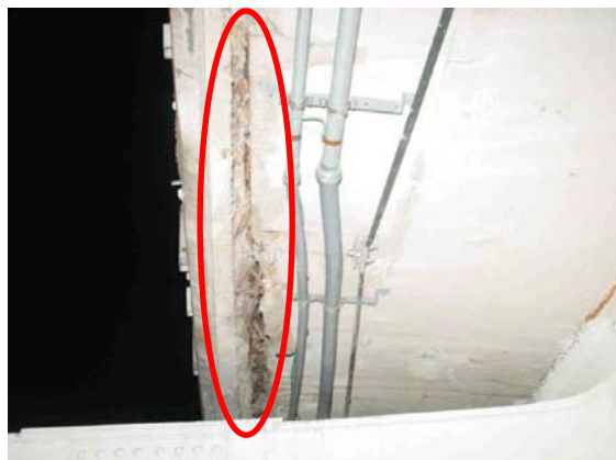
写真-1 高欄・床版取合い部のひび割れ
