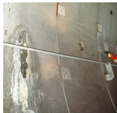
写真-1 注入孔からの漏水状況
