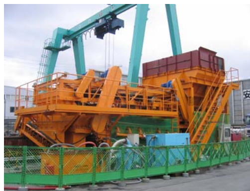
写真-1 脱水ベルコン全景
