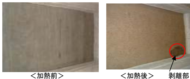
写真-3 加熱面状況
