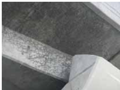
写真-3 亀甲状のひび割れ
