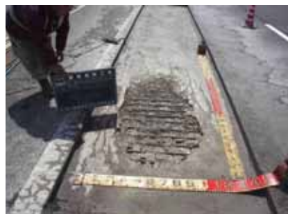
写真-1 床版上面の骨材化
