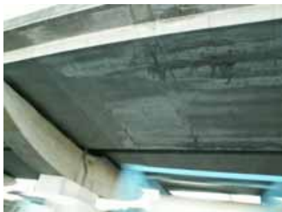
写真-2 橋軸方向のひび割れ
