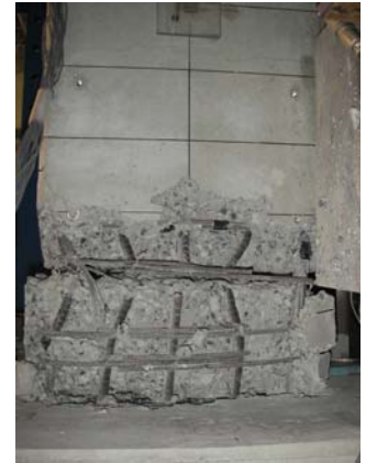
写真-1 鉄筋破断状況 (No.1)
