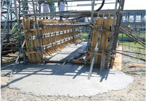
写真-1 コンクリート流出状況
