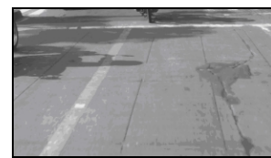
(a) 損傷のある舗装の画像
