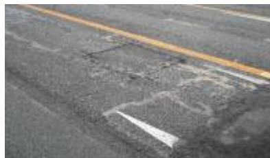
写真-2 未補修区間の路面
