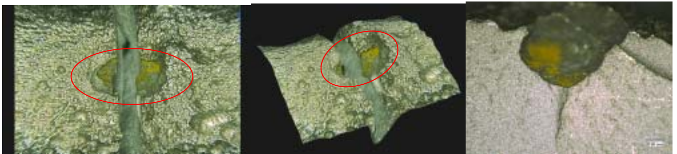
写真-2 腐食鉄筋破断部(左, 中; 腐食ピット 右; 腐食ピットからの疲労亀裂起点)
