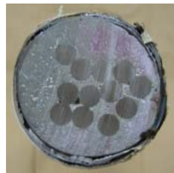
図-2 シース内のPC鋼材の内蔵状況
