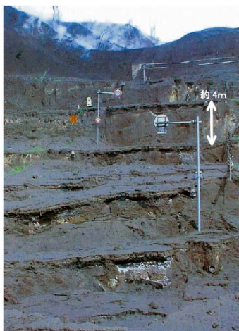
写真1 地殻変動により地溝が発生した一般国道230号 1)
