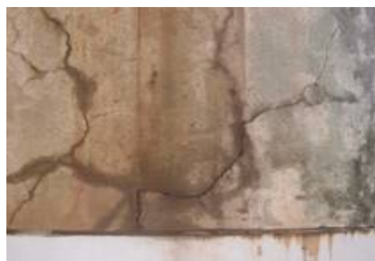
写真 1 B 橋脚ひび割れ状況
