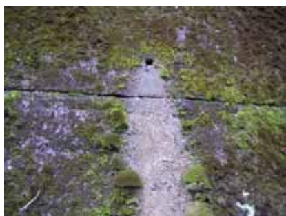
写真-1 水抜き孔からの土砂流出
