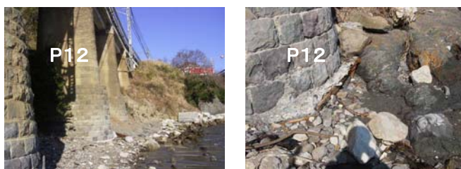
写真-1 橋脚基礎浸食状況
