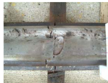
写真－1 頭頂面の状態
