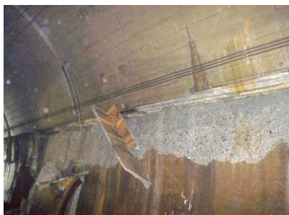
写真-3 第二米山トンネル 写真 (側壁上部コンクリート剥落状況)
