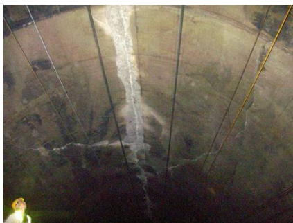
写真-1 第一米山トンネル(天端) (圧ぎ, せん断ひびわれ状況)
