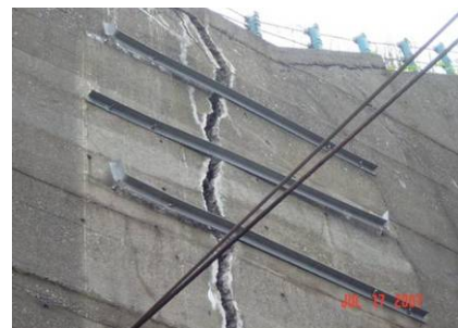
写真-4 第三笠島トンネル (側壁上部コンクリート剥落状況)
