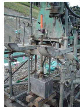
写真-2 設置状況
