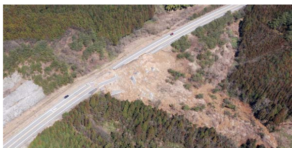
写真-1 能登有料道路（縦 38）の崩壊状況 1)
