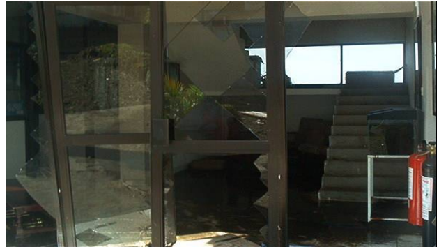
写真-3 津波被害状況（構造物被害レベル 2）
