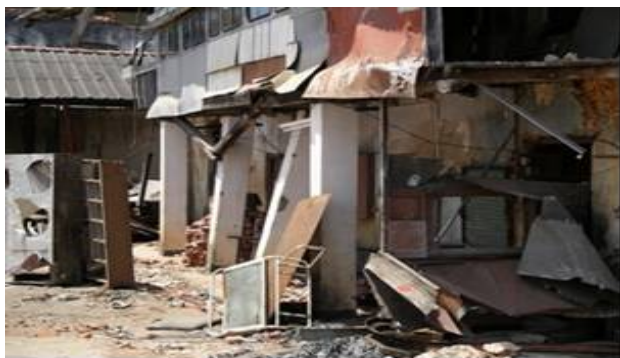
写真-1 津波被害状況（2004 年インド洋大津波）
