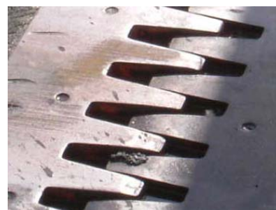
図3 P6 支承付近伸縮装置段差
