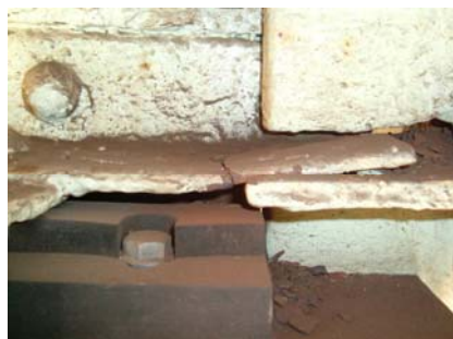
図1 P6 縦桁下フランジ変状の様子
