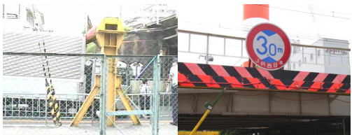
Fig.7 試験設置箇所の橋桁防護工への自動車衝撃事故状況写真
