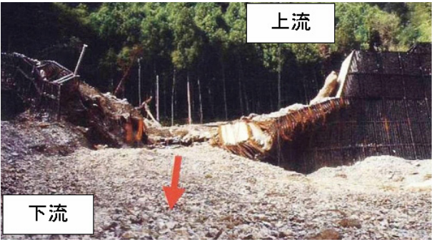
写真-1 破壊事例
