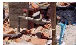
図-1 水道メーター
