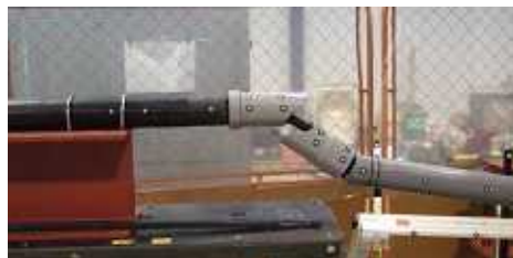
図7 伸縮継手破損状況
