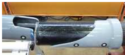
図4 伸縮継手破損状況
