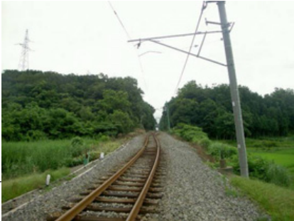
写真－1 盛土被災状況 (越後線西中通－荒浜間 No.1)
