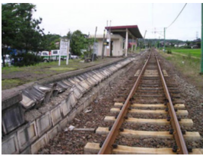
写真－2 盛土被災状況 (越後線荒浜駅 No.6)
