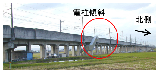
図3 脱線箇所付近の架線電柱の傾斜
